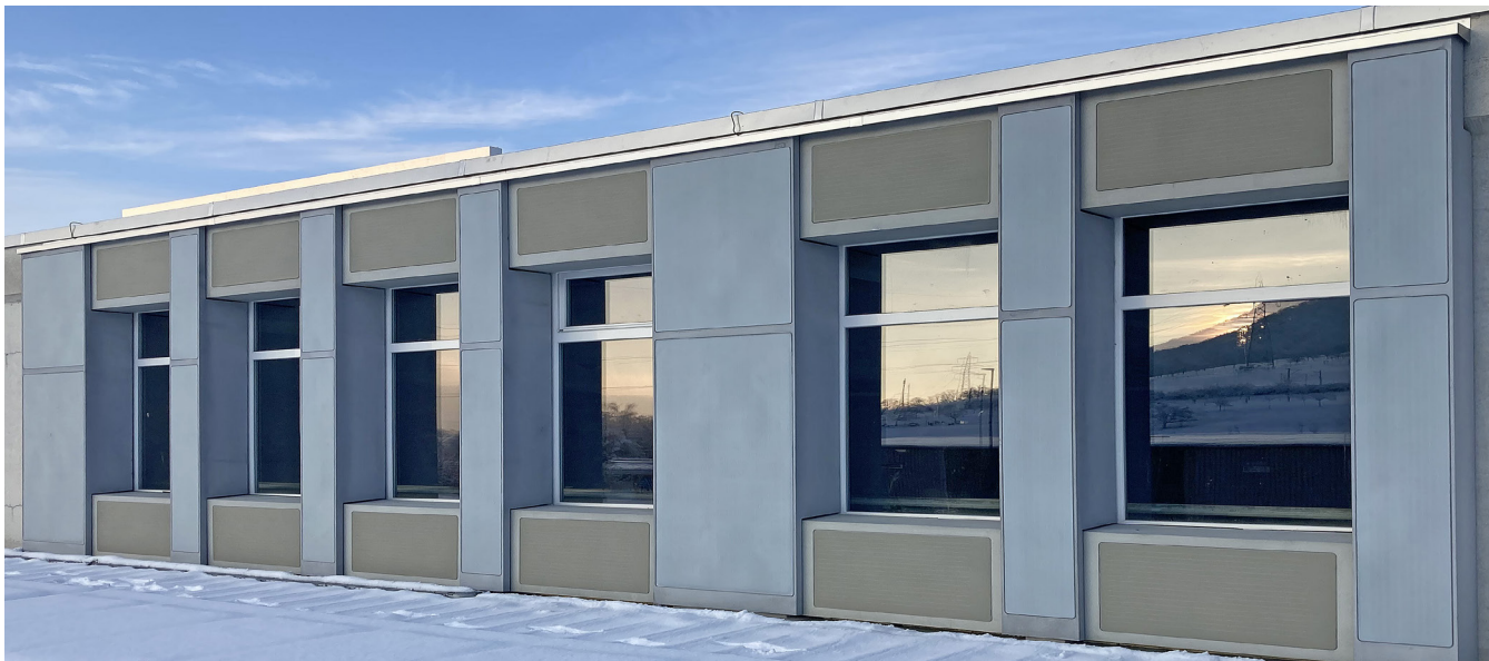
Fassadenelemente mit integrierten PV-Modulen, Frick
