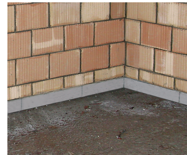
Feuchtigkeit in der Bauphase
