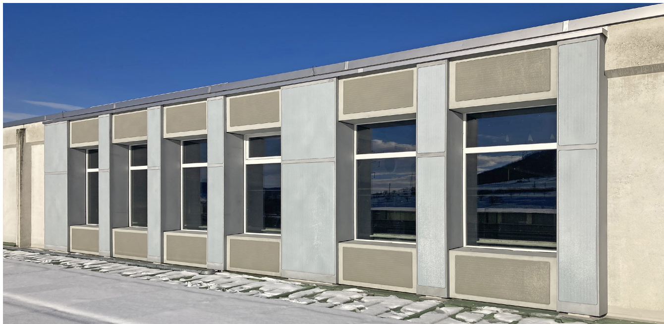
Éléments de façade avec modules PV intégrés sur l'atelier de Stahlton Bauteile AG à Frick
